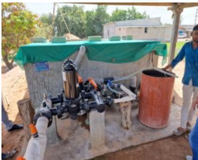
Pumpen befördern Grundwasser zu den Verteilern der Tropf-Bewässerungsschläuche. Flüssigdünger kann zugeschaltet werden.
